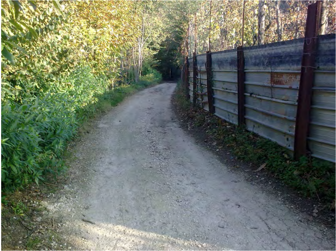
Contenimenti in lamiera da sostituire con gabbionate rinverdite
